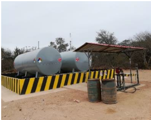
Área de almacenamiento de combustible
