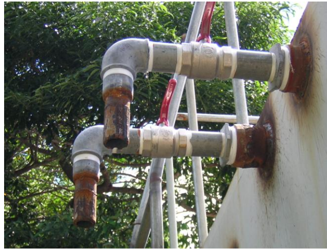
Figura 8.6.- Fotografías de las válvulas de afluentes a la planta de lodos activados de IST Ltda.
