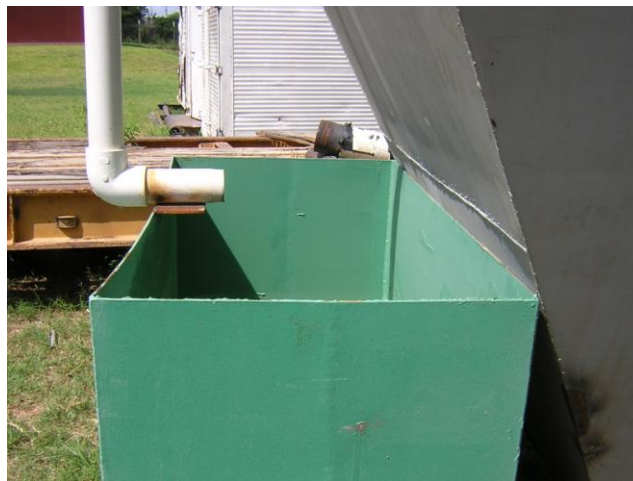
Figura 10.1.- Fotografía del tanque de almacenamiento de agua residual tratada de la planta de lodos activados de IST Ltda.
